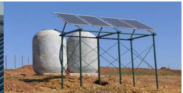
Bombas FV para riego
